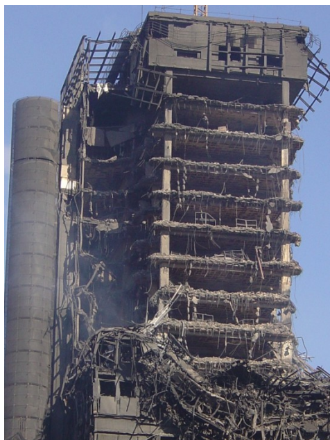
Torre Windsor (Madrid) tras su incendio en 2005
